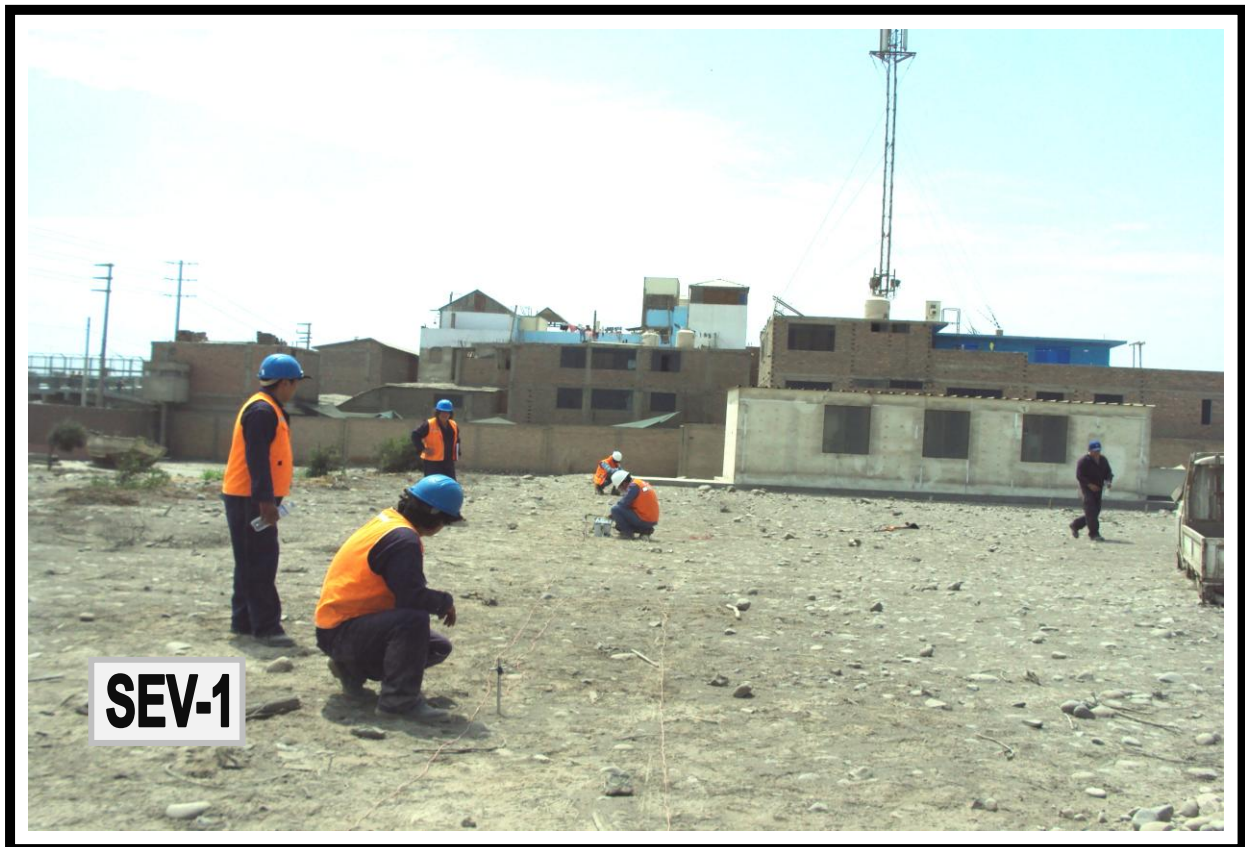
Fotografía 13 : Vista Mostrando el Sondaje Eléctrico Vertical (SEV-1), Realizado con Equipo de Resistividad Eléctrica.
