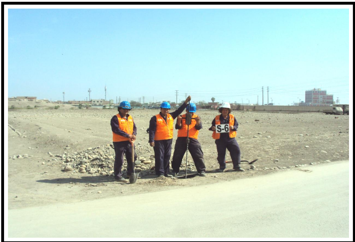
Fotografía 08 : Vista Mostrando el Sondaje (S-6), Realizado con Equipo de Penetración Dinámico (Cono de Peck).
