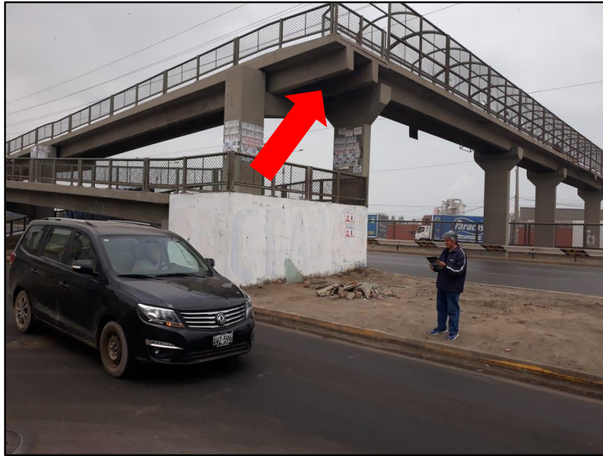
Puente Peatonal que permite la circulación peatonal, se encuentra con rejillas de seguridad, de acuerdo a la normativa vigente
